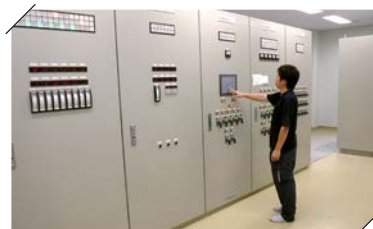
浄水場全体をモニターで確認中
