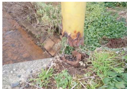
防護柵の腐食・破断
