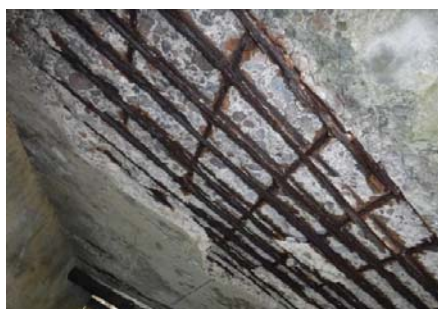
床版の鉄筋露出
