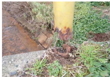
防護柵の腐食・破断
