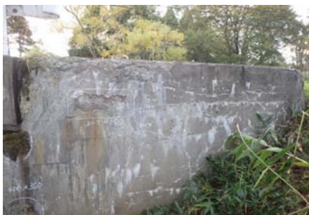
橋台の遊離石灰を伴うひびわれ
