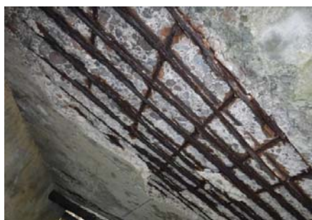
床版の鉄筋露出
