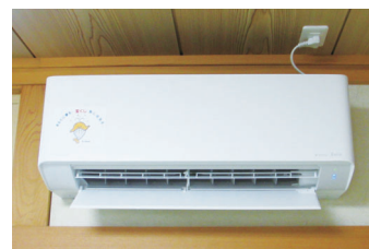
▲設置されたエアコン
