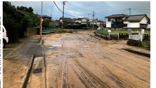
琴浦地区・冠水後の水が引いた道路
