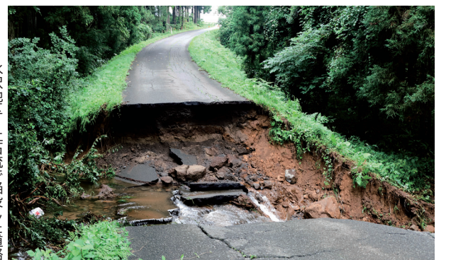
水沢地区・土石流で陥没した道路
