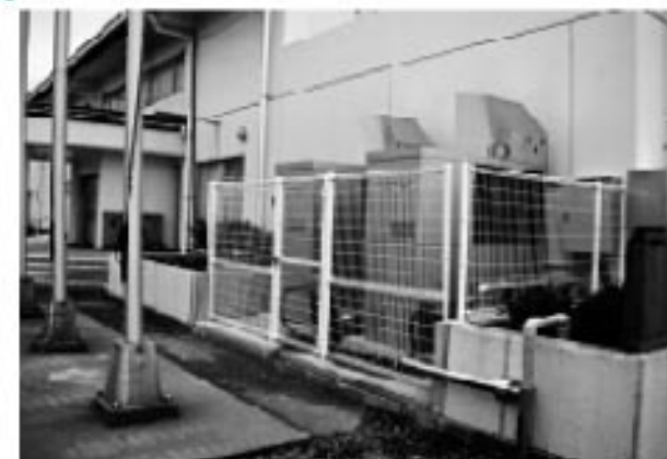
センターに設置された2台の発電装置
