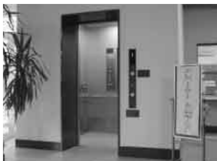
公民館に設置されたエレベーター
