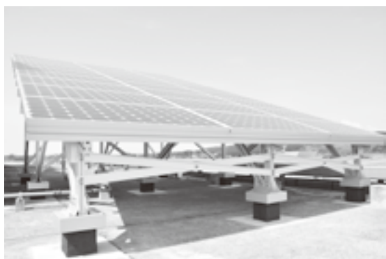
象潟庁舎屋上に設置されている太陽光パネル
