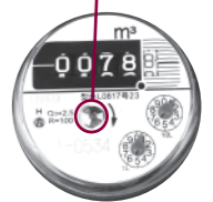
メーターパイロット
