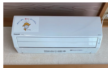
▲設置されたエアコン
