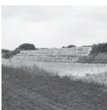
護岸崩落した白雪川(田爪)
